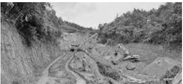
5月2日,广东梅大高速路面塌方灾害现场。图为多台挖掘机仍在作业。
