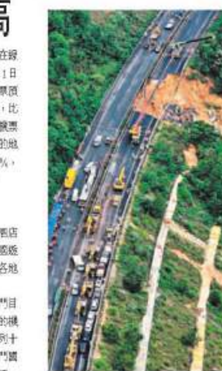
◆5月1日，梅大高速發生塌方事故，圖為救援現場。
