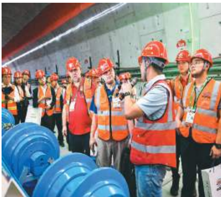
近日，2024年世界隧道大会在广东深圳举行，吸引来自全球隧道工程产业链的近200家客商参加，展览规模、参与人数均创新高。本届大会专门设置了技术参观线路，由深铁集团建设、中铁二十二局集团施工的穗莞深城际前皇段区间盾构隧道工程受到与会嘉宾广泛关注。该工程是国内外同类工程中施工难度最大的盾构隧道工程之一。图为世界隧道大会观摩团在工程现场参观。桂天奇摄（人民视觉）
