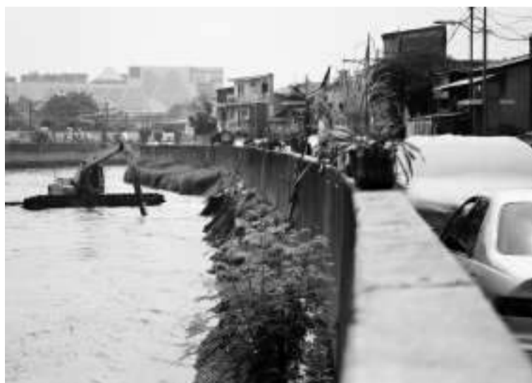
疏浚芝利翁河河道 5月4日,为防止雅加达境内芝利翁河变浅并防止洪水泛滥,工人使用重型设备挖掘河底泥浆,疏浚河道。
